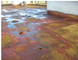
terrazzo copertura poliuretanic... 7° piano scal...
