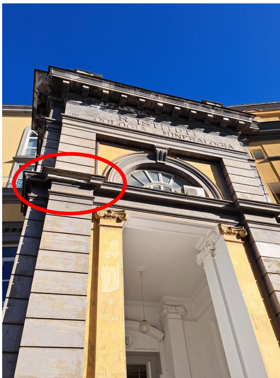
Foto 2 – Dettaglio della facciata con individuazione della porzione di cornice interessata dal distacco
