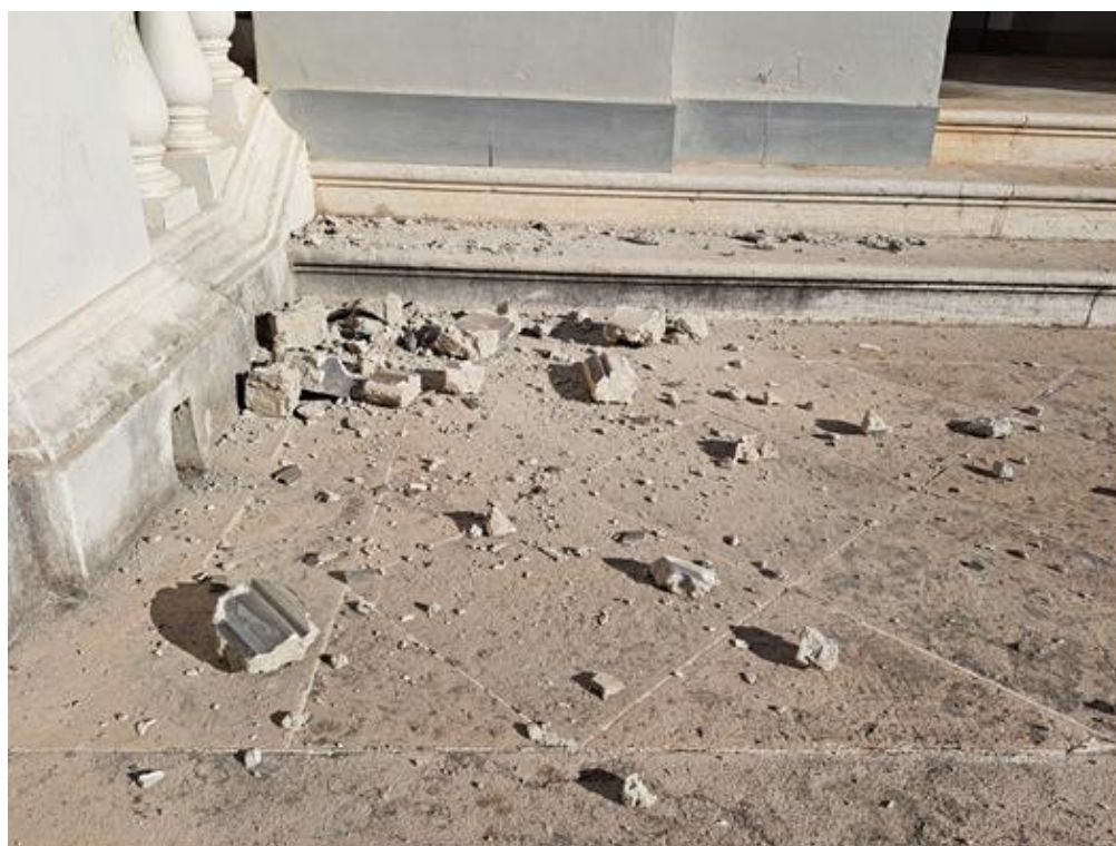
Foto 5-6 – Materiale distaccatosi dalla cornice e rinvenuto sul pianerottolo
